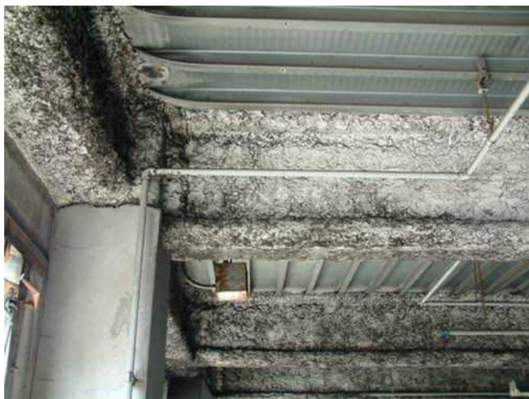
②石綿含有吹付けロックウール
