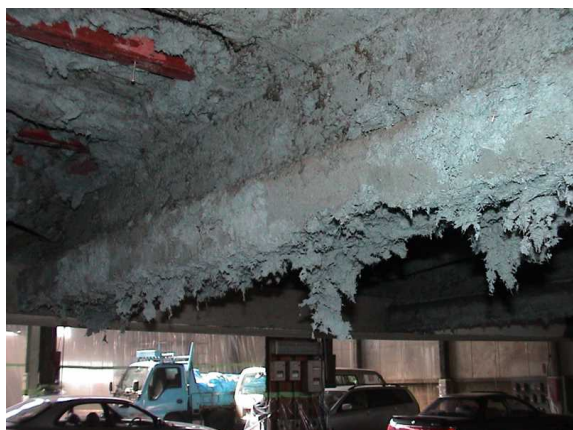
レベル1: 吹付け石綿（クロシドライト）
