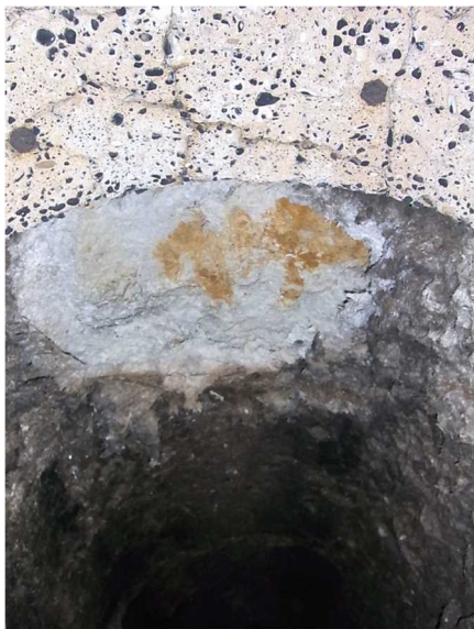
①煙突用石綿断熱材
