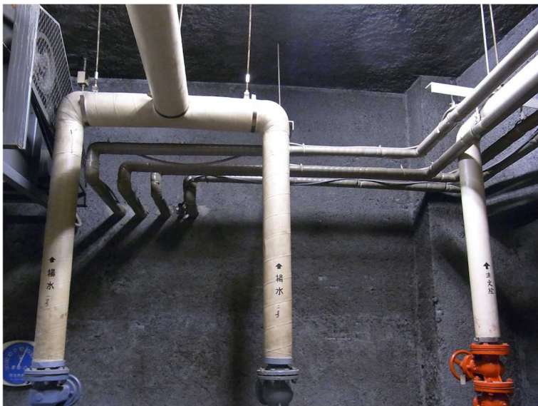
①吹付け石綿(クロシドライト)
